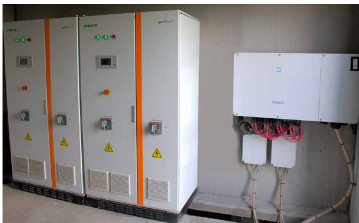
A SINISTRA I DUE VECCHI INVERTER SUNGROW SG100K3, ANCORA PIENAMENTE OPERATIVI DOPO DIECI ANNI DI SERVIZIO, SONO AFFIANCATI DAL NUOVO MODELLO SG110CX
