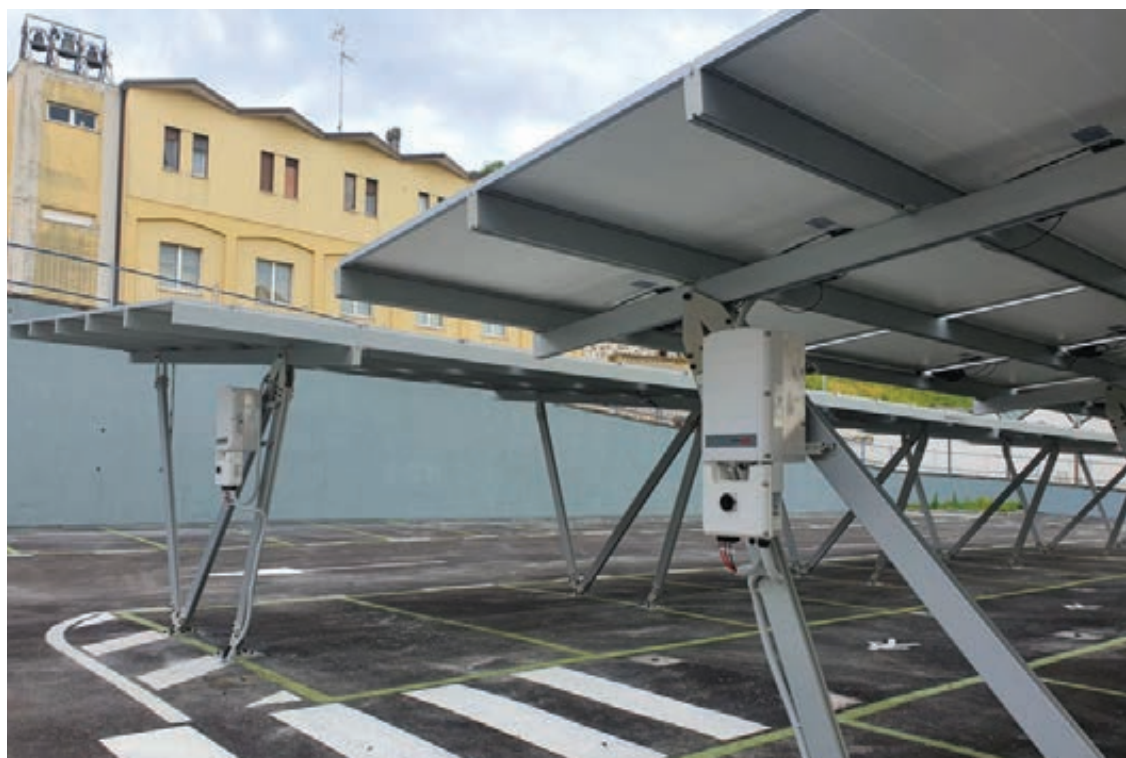
PER ENTRAMBE LE PENSILINE SONO STATI IMPIEGATI GLI INVERTER SOLAREEDGE SE27.6K E 80 OTTIMIZZATORI P850 SEMPRE DELLO STESSO MARCHIO
